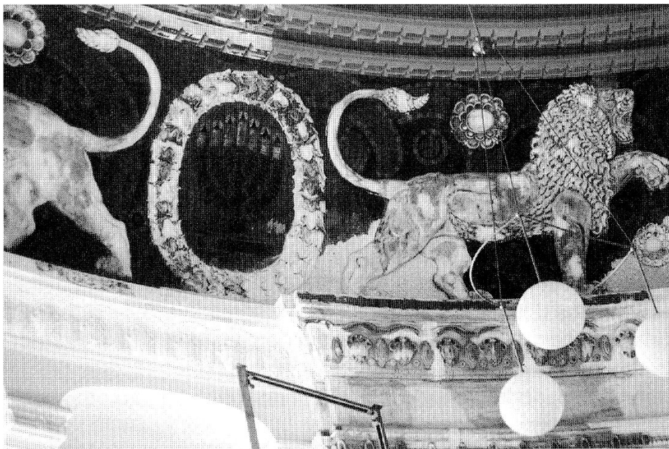
Synagoge in Görlitz: Blick in die Kuppel. Obwohl sie sich noch in der Restaurationsarbeit befindet, zeichnen sich ehemalige und zukünftige Schönheit ab.
